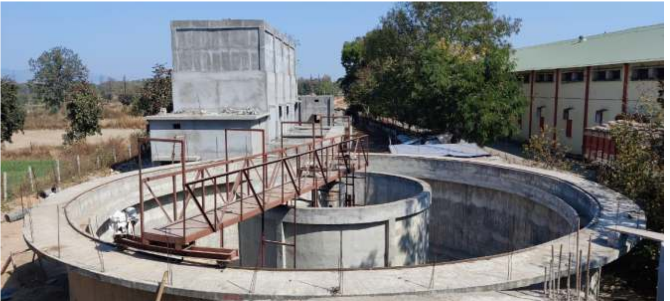
कोटा नगर की आवर्धन जल प्रदाय योजना अंतर्गत निर्माणाधीन जल शुद्धिकरण संयंत्र
